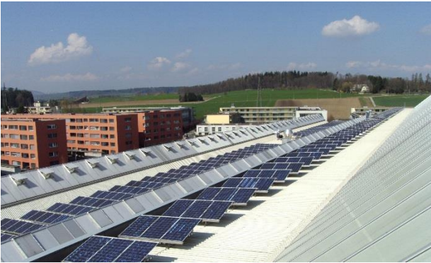
156 kW-Anlage Tramonthalle in Zürich
