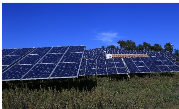
1 MW-Anlage Sainte Maxime an der Côte d'Azur
